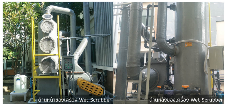
ด้านหน้าของเครื่อง Wet Scrubber
